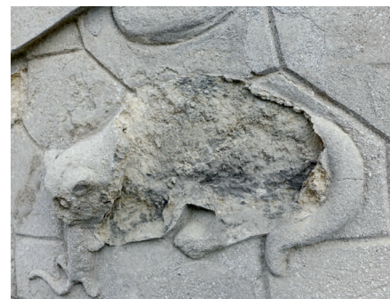
Abb. 7: Zustand 2023 nach Abnahme des schadhaften Stein- und Kunststeinmaterials
